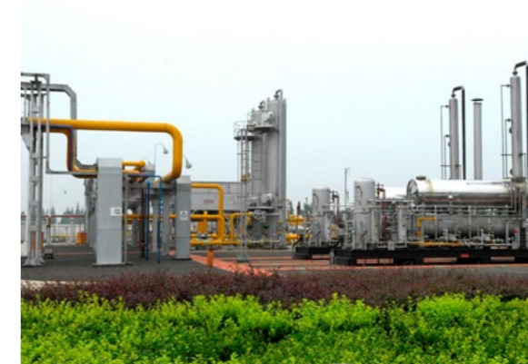
中盐金坛建设的全国第一个商用盐穴储气库
